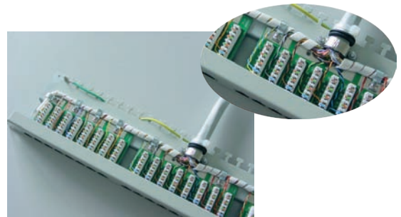
Patch Panel 24 Port mit Belegung
